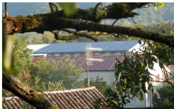
La centrale photovoltaïque en intégration simplifiée
